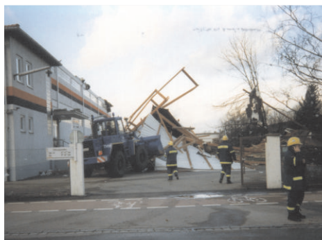
Einsatz des Bergungsräumgerätes bei Sturmschäden
