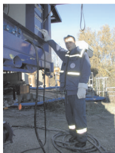
Heiko Schwarz beim Betrieb einer Netzersatzanlage
