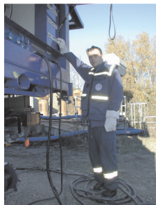
Heiko Schwarz beim Betrieb einer Netzersatzanlage
